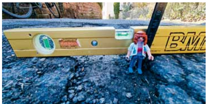
Den absolut objektiven Beweis für einen zum Radfahren untauglichen Straßenbelag liefert das Auflegen einer Wasserwaage. Foto: boxbergbike
